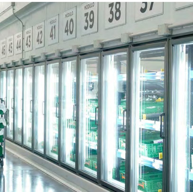
Instalaciones del interior de la Colmena de Madrid, Madrid.
